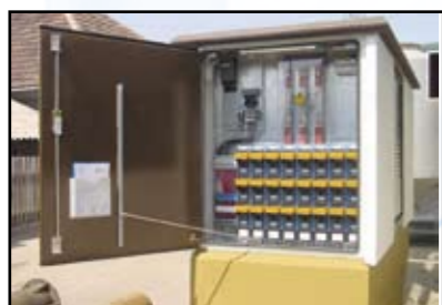
L.V. panel equipped
